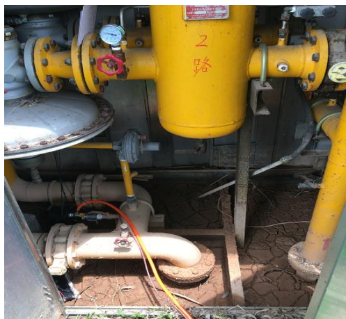
图 2-6 调压箱低压放散口
